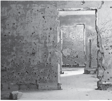
Zerschossene Räume in Quneitra, Syrien 2013. Foto : Joel Carillet / iStock
